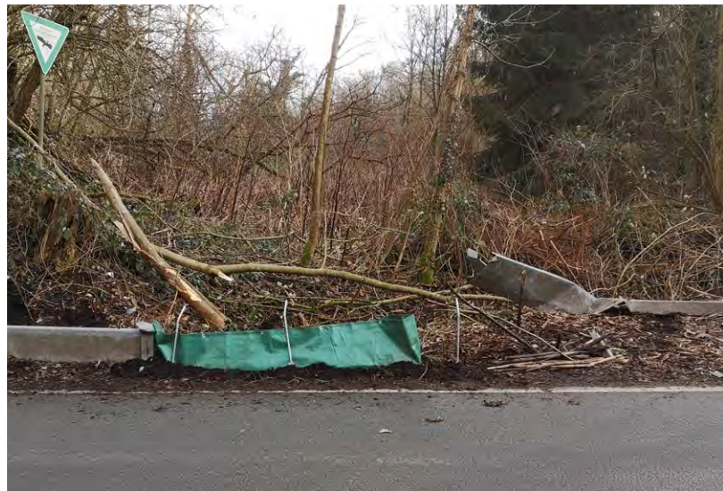
Abbildung 58: Errichtung eines Krötenzauns als provisorischer Verschluss der beschädigten Amphibien-Leitanlage am Charlottenberg.
