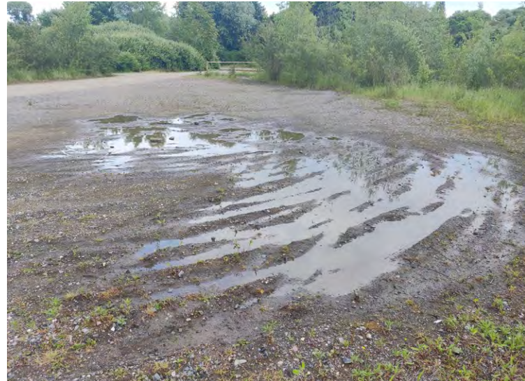
Abbildung 100: Schotterfläche mit wassergefüllten Spurrinnen vor dem Pumpwerk.
