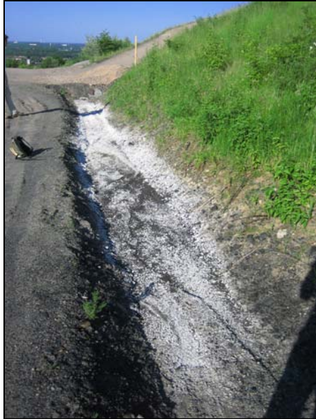
Abb. 3: Salzausblühungen auf der Halde Hoheward in Herten
